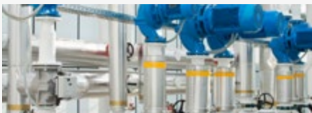
BOMBEO DE AGUA
